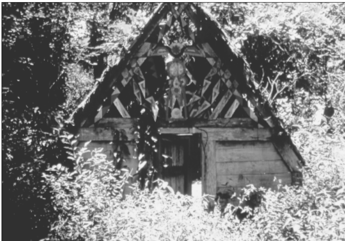
photo 38 : Ce carbet aluku en ruine traduit un abandon accéléré depuis quinze ans de l'habitat ancien, au profit de maisons à étage couvertes de tôles ondulées (Papaïchton, haut Maroni, Guyane Française). (cliché J. F. Orru, 1996)
