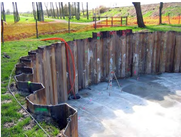
Figure 15 : Berge aménagée en palplanches en France Hexagonale.
