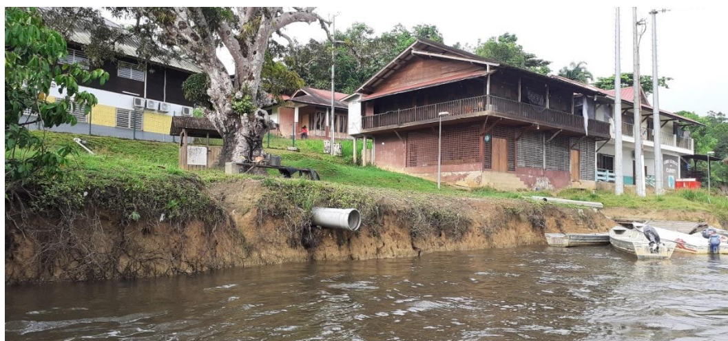
Figure 19 : Evacuation canalisée, témoin de recul des berges, prise de vue 21/07/2021 (PAG)
