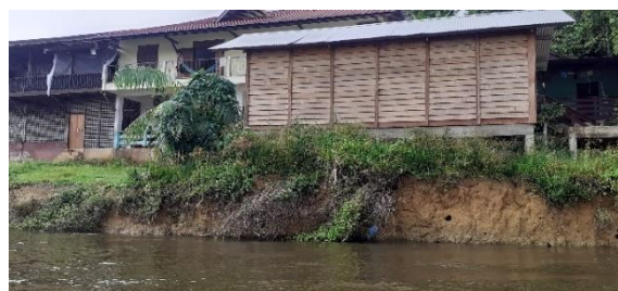
Figure 59 : Prise de vue du 21/07/2021 (PAG) bâtiment privé en face de l'épicerie du bourg
