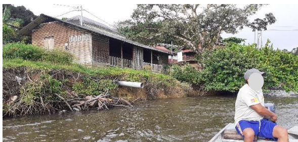
Figure 20 : Bâtiment privé vulnérable, canalisation témoin du recul des berges, prise de vue 26/07/2021 (PAG)
