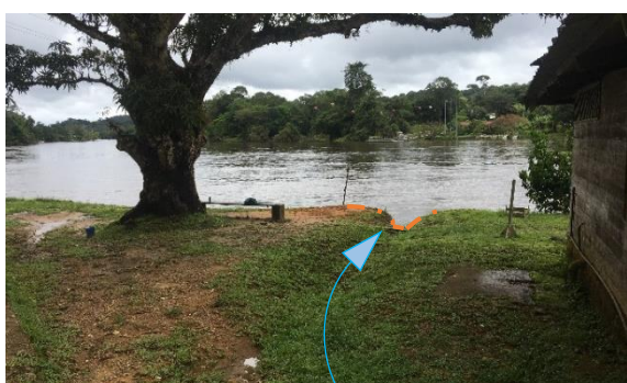
Figure 50 : Prise de vue le 16/05/2022 (PAG), écoulement des eaux pluviales, rejet du fossé non aménagé directement dans la rivière Camopi
