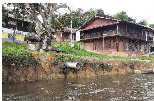
Figure 51 : Prise de vue le 21/07/2021 (PAG), écoulement des eaux pluviales, rejet du fossé non aménagé directement dans la rivière Camopi
