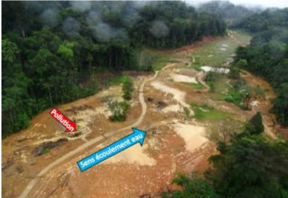
Figure 14 : travaux réhabilitation en saison des pluies AEX 09/20 Société CORREI – 10/03/2023 © J-M. Guiraud (phase IV). Constat pollution, ne faisant pas l'objet d'un PV car considéré comme non volontaire.
