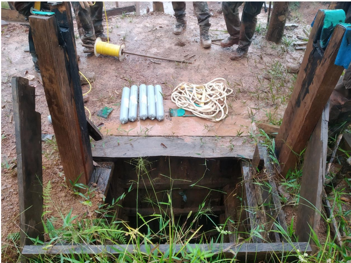
Figure 13 – Puits clandestin et matériel de la sécurité civile nécessaire à sa destruction.
