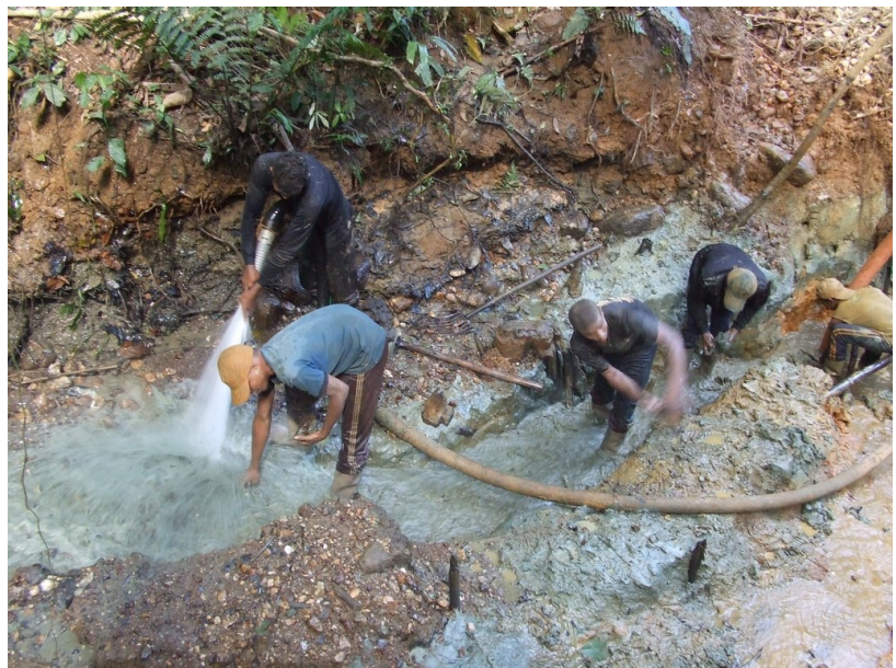
Piquets supports de sluices anciens dégagés par les travaux des mineurs clandestins ; crique Roche, 2009.
